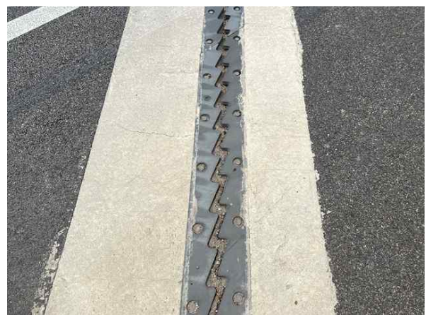
신축이음 A1 후타재 균열(Cw=0.3mm미만)
