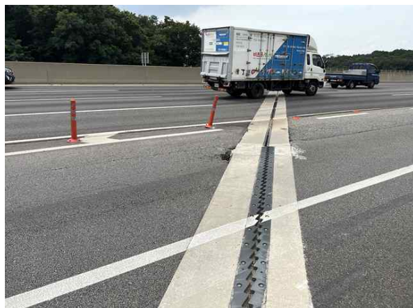
교면포장 S1 접속도로 아스콘 파손( 0.3 \times 1.0 )
