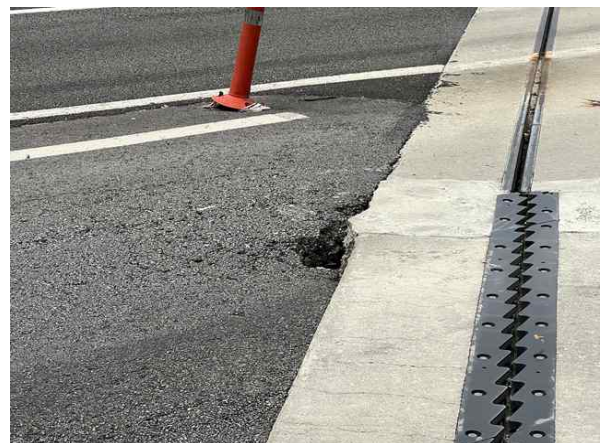
교면포장 S1 접속도로 아스콘 파손( 0.3 \times 1.0 )
