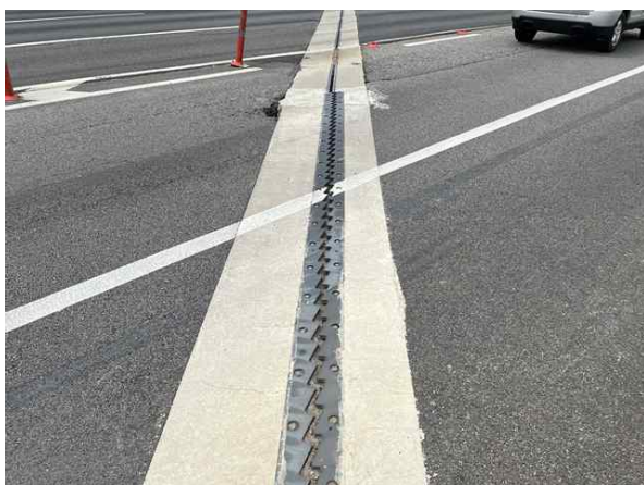
신축이음 A1 후타재 균열(Cw=0.3mm미만)
