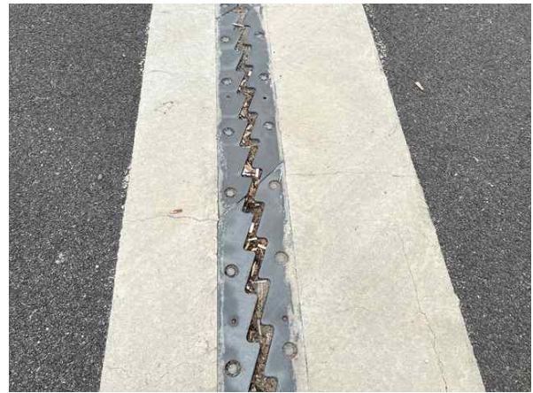
신축이음 A2 후타재 균열( Cw=0.3\text{mm} 미만)
